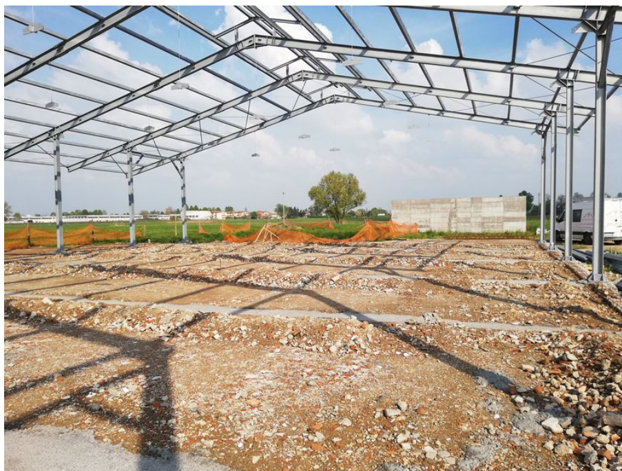
Figura 3.1 – La situazione della nuova stalla compost dell'azienda A nel momento dell'interruzione dei lavori di costruzione
