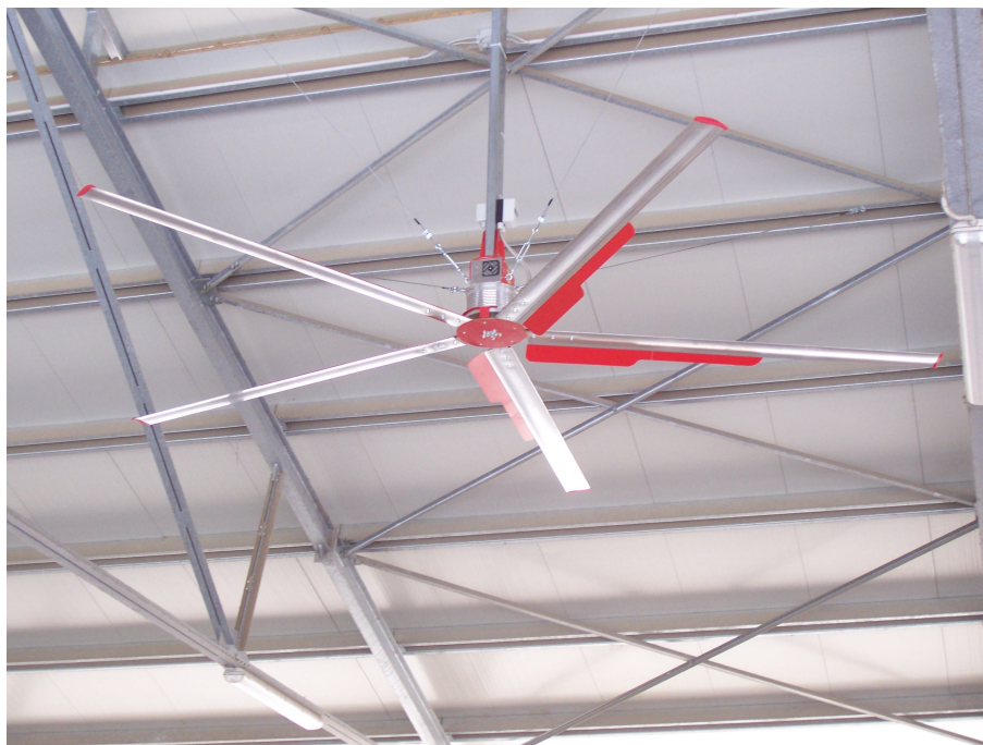
Figura 1.5 – Ventilatore assiale a pale di grande diametro del tipo “elicottero” a cascata d'aria, per il raffrescamento delle aree di stabulazione
